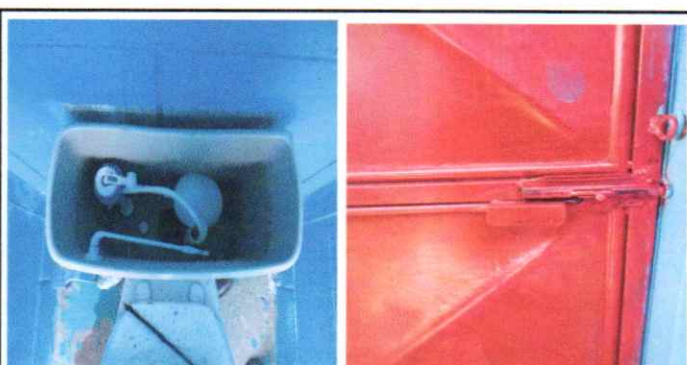
Foto 6: Quit de baños sustituidos y pasadores de puertas
