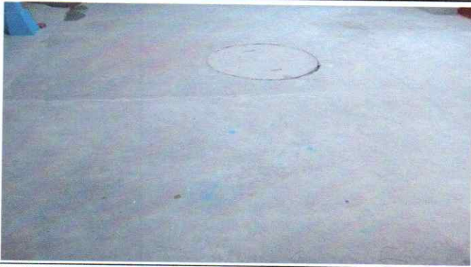
Foto 3: Torta de cemento sustituida
